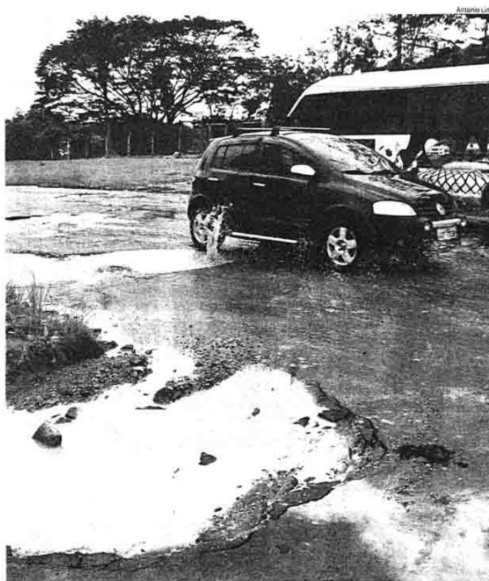
Na avenida Abiurana o asfalto está todo esburacado e os veículos disputam o espaço que ainda está em condições
