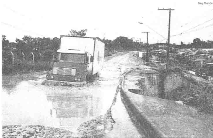
Buraco começou pequeno, mas a força das águas e uma intervenção mal sucedida acabou transformando a pista
