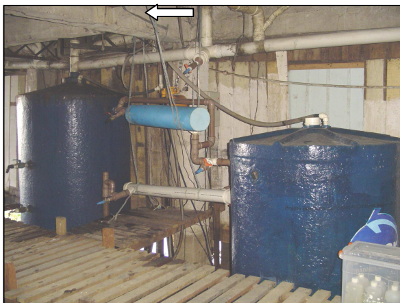
Figura 4: Equipamentos da unidade piloto de tratamento de esgoto instalada sob palafitas no Igarapé Educandos em Manaus-AM.
