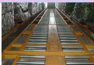
366 posições de Racks fixos, 05 transferidores e 03 giratórios
