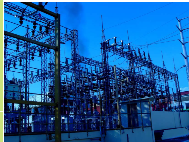
SUBESTAÇÃO DA TERMELETRICA DE APARECIDA
