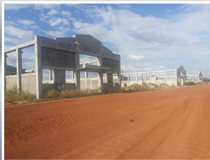
Instalações do Polo Moveleiro Situação atual: obras paralisadas
