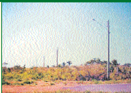
3 - Rua C - Rede de baixa tensão e iluminação pública
