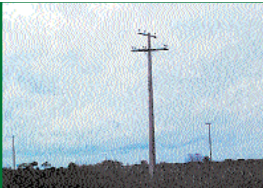
2 - Vista da Rede Elétrica em Ariquemes
