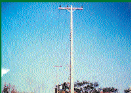
4 - Rede de baixa tensão e iluminação pública
