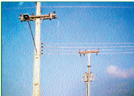
1 - Vista Geral da Rede Elétrica
