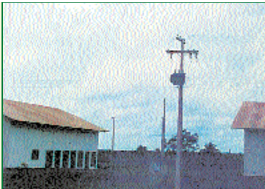
1 - Vista da Rede Elétrica em Ariquemes
