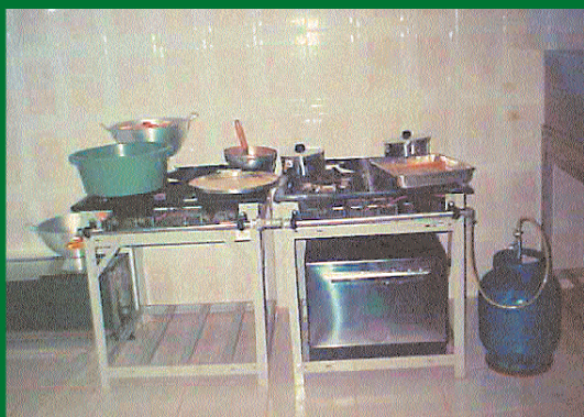
4 - Vista dos Equipamentos
