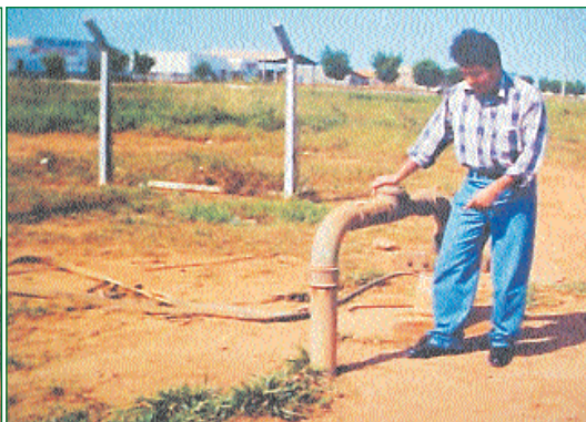
2 - Poço artesiano - abastecimento de água
