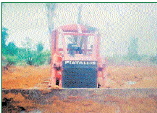
1 - Vista dos equipamentos0
