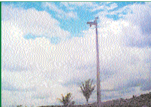
2 - Rede Elétrica Linha 647
