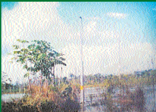
4 - Rede Elétrica Linha 632
