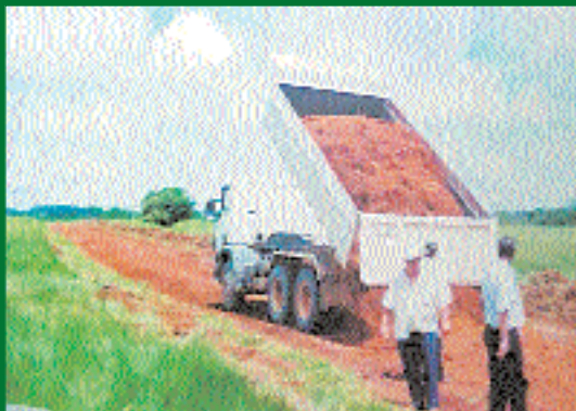
4 - Caminhão Basculante (truck)
