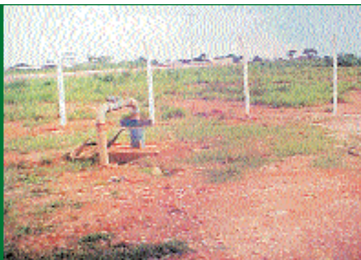
2 - Vista Geral do Poço Artesiano
