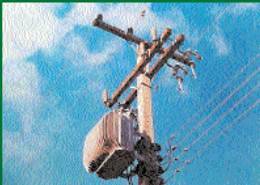
4 - Vista da Rede Elétrica em Ariquemes
