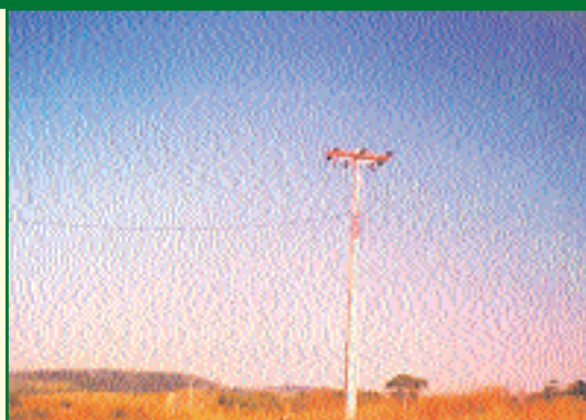
3- Vista da Rede de Elétrica no Vale do Paraíso
