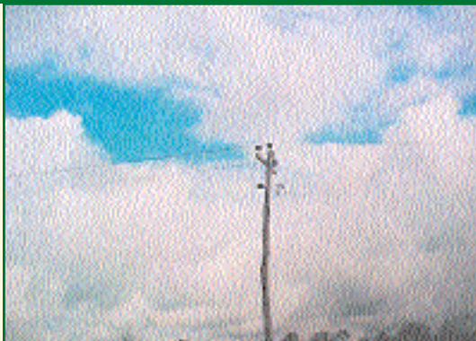
3- Rede Elétrica Linha 632
