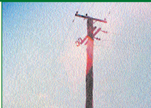
3 - Vista da Rede Elétrica de Alto Paraíso
