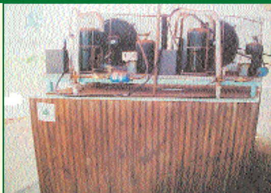
3 - Vista Conjunto de resfriamento de leite
