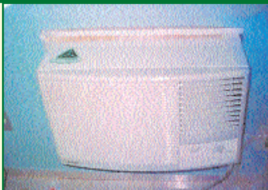
3 - Vista dos Equipamentos
